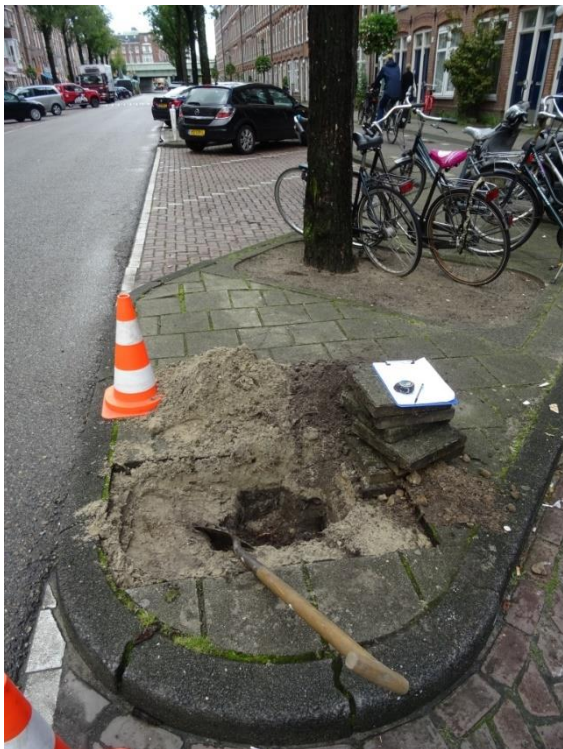
Bomenzand bij boom 52. Op 45 cm-mv is een oude verhardingslaag aangetroffen.
