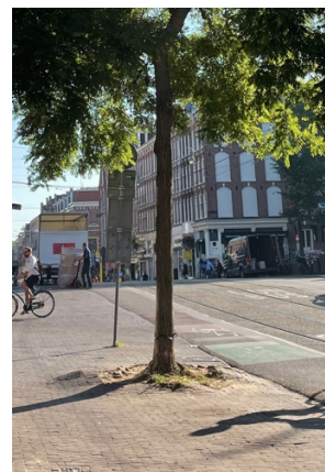
Afbeelding 13: Sterk opgedrukte bestrating door boomwortels
