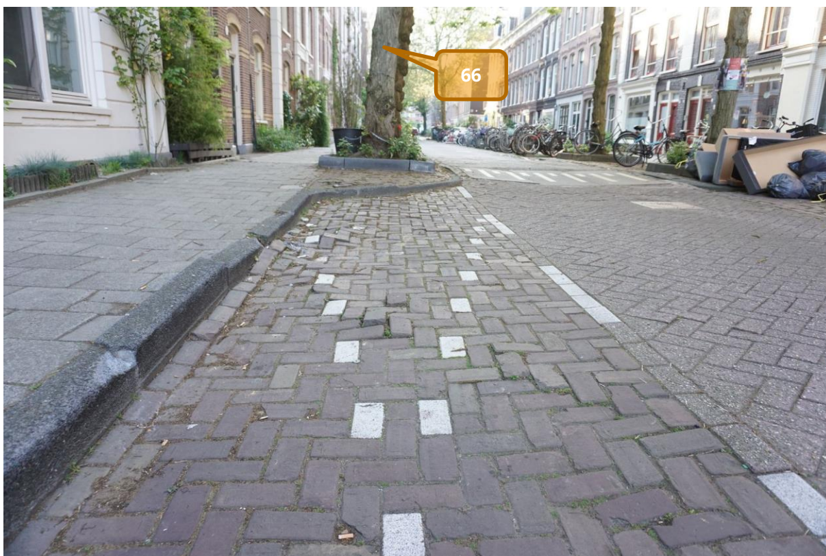
Foto 15: Beeld van ernstige wortelopdruk ter hoogte van boomnummer 66, dit in zowel rijbaan, parkeerstrook als trottoir.
