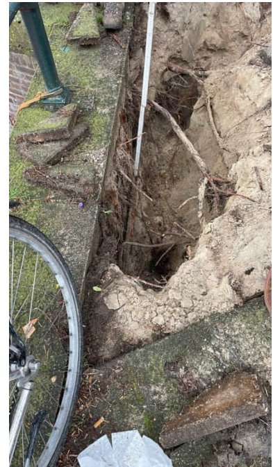
Afbeelding 19: Grovere beworteling (1,5 cm doorsnede) langs de kademuur
